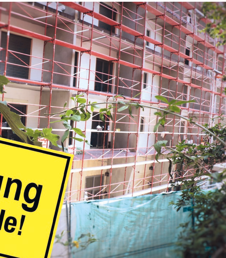
Lebensgefährlich! Vom Balkon geht es direkt 5 Stockwerke in die Tiefe.
