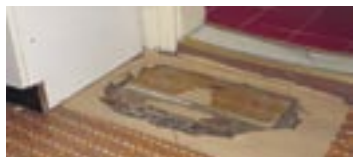
Der Fußboden ist eingebrochen.
