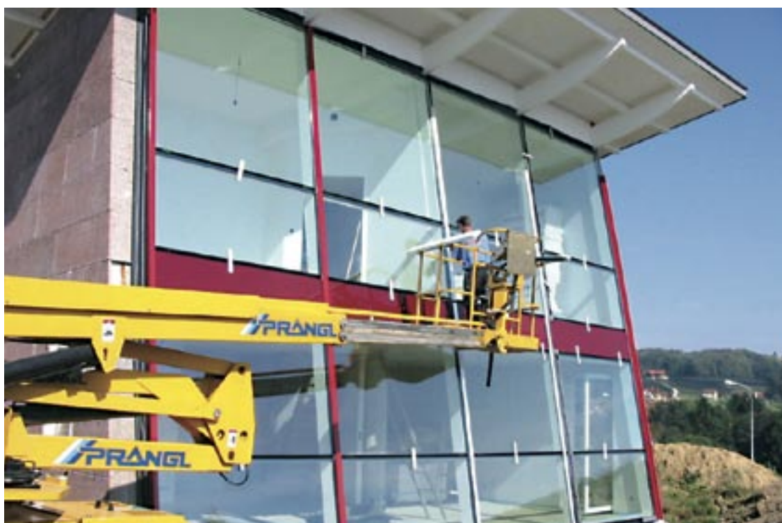
Schaut toll aus, aber Fehler in der Unterkonstruktion trüben die Freude: Das Haus Neuhold in Gleisdorf.
